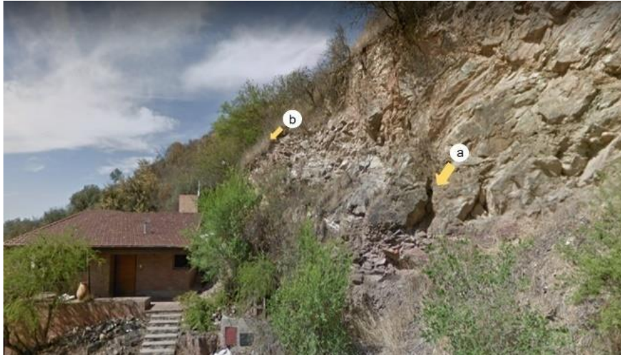
Figura 88. Calle Los Cerros: ruptura de equilibrio de la ladera por acción antrópica. (a) Potencial caída de rocas y deslizamiento por coincidencia de la foliación con la pendiente natural y (b) reptación en manto de la cubierta de suelo superficial. Fuente: propia.
